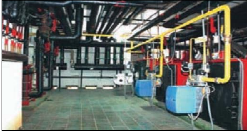
Fig. 2.5.: Sala de calderas.
