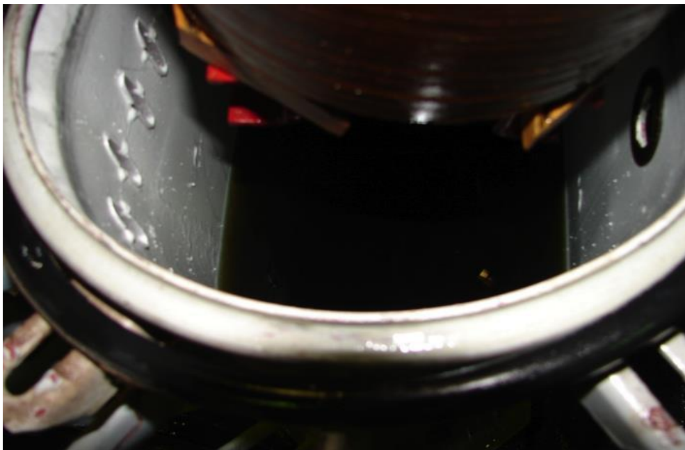
Figura 4.2 Coloración oscura del aceite del transformador 1
