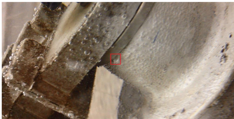
Figura 4.30 Falla de sellado en el pararrayos.
