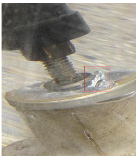
Figura 4.29 Falla de sellado en pararrayos, evidenciado por la salida de burbujas.
