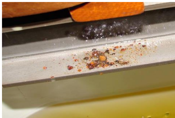
Figura 4.6 Detalle de las costras de óxido en la culata del transformador 2
