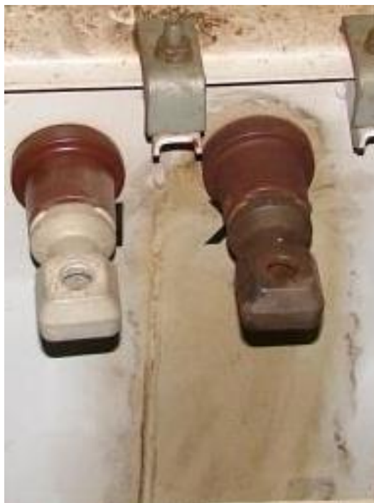
Figura 4.5 Manchas en el tanque del transformador 2 indican vaciamiento del aceite aislante en el terminal X2 de baja tensión es diferente de los demás, mostrándonos que fue reparado.
