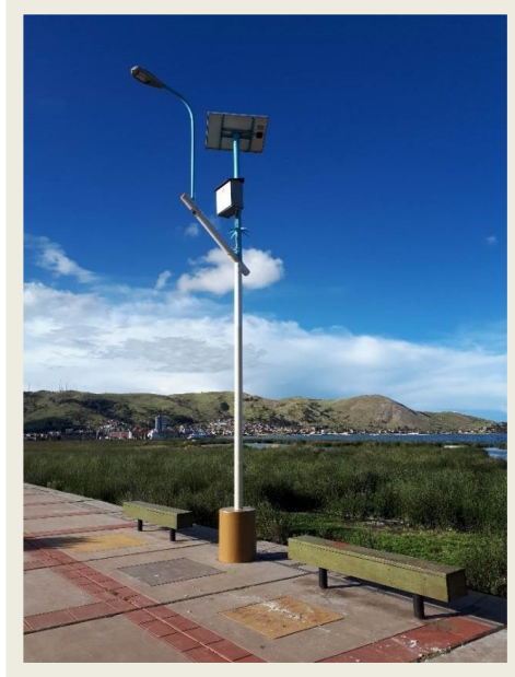
Figura 71. Luminaria de Av. costanera 2018
