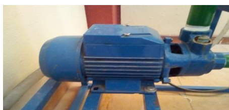
Figura 3.3: Bomba de Agua utilizado en el proyecto
