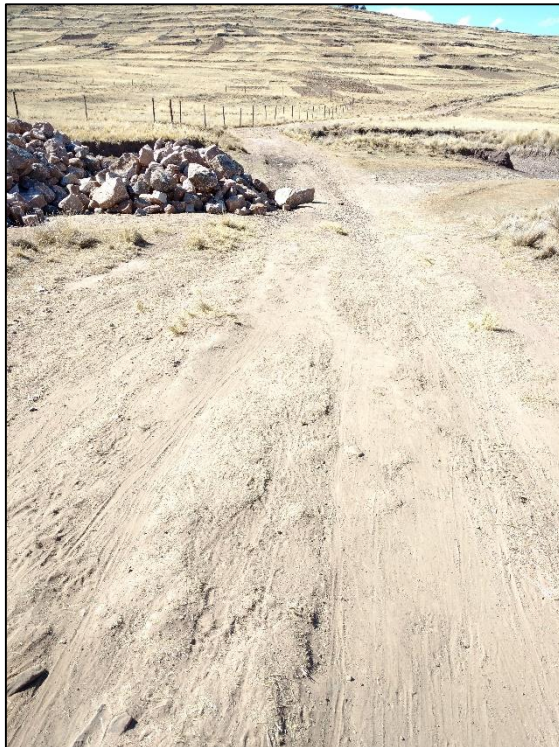
FOTO N° 15: NO CUENTA CON ALCANTARILLA DE DRENAJE
