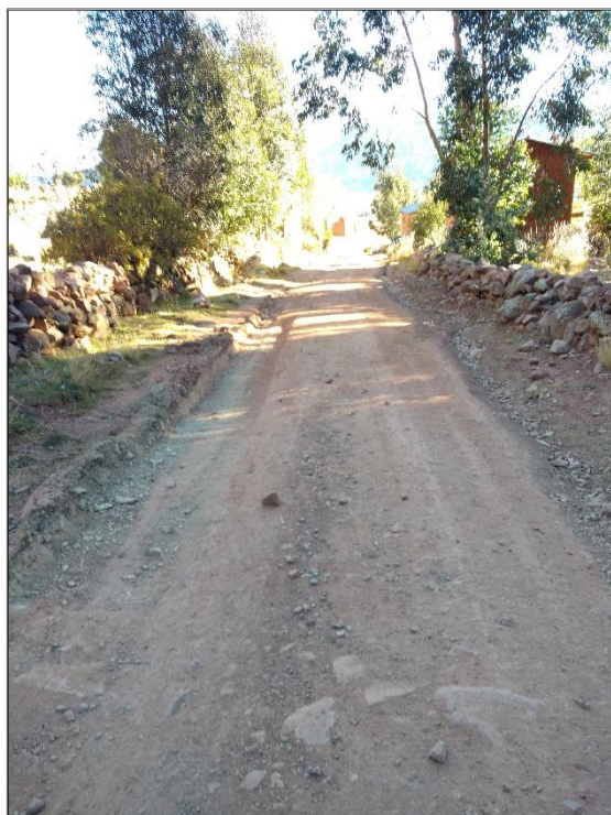
FOTO N° 01: CARRETERA SIN CUNETAS
