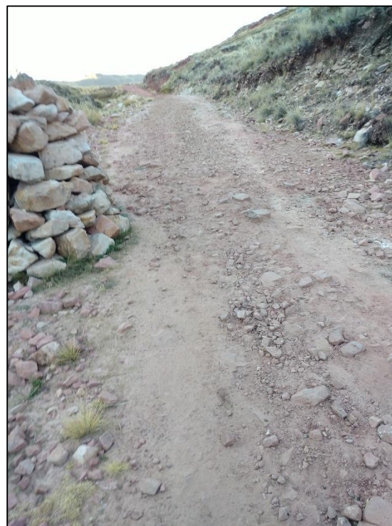
FOTO N° 02: PLATAFORMA DE LA VIA SE ENCUENTRA EN TOTAL DETERIORO
