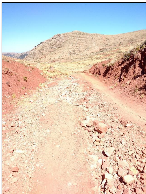
FOTO N° 09: DETERIORO DE LA PLATAFOMA DE LA CARRETERA
