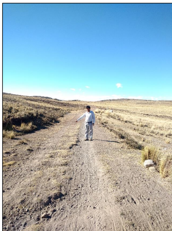
FOTO N° 28: SE OBSERVA PERDIDA TOTAL DEL AFIRMADO EN LA VIA
