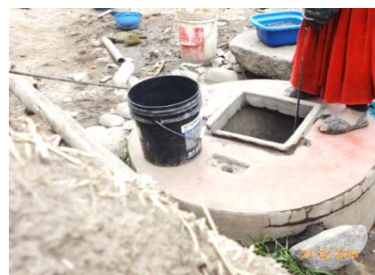
Pozo existente – en mal estado
