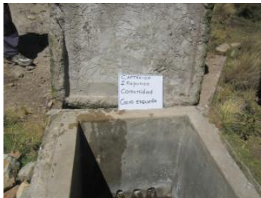
Figura N° 08: Cámara de reunión de la captación existente
