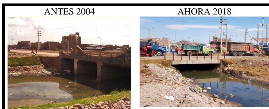
Figura N° 127: Vista del puente San Isidro antes y después Fuente: Elaborado por el equipo de trabajo
