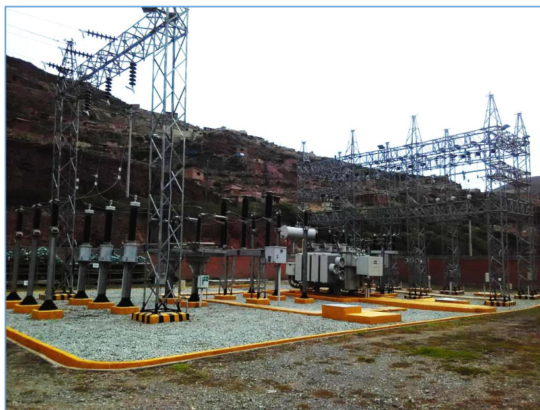
Figura N° 3. 4: S.E. Urubamba. Barra de 10.0 kV y salidas UR-02, UR-01, UR-05.
