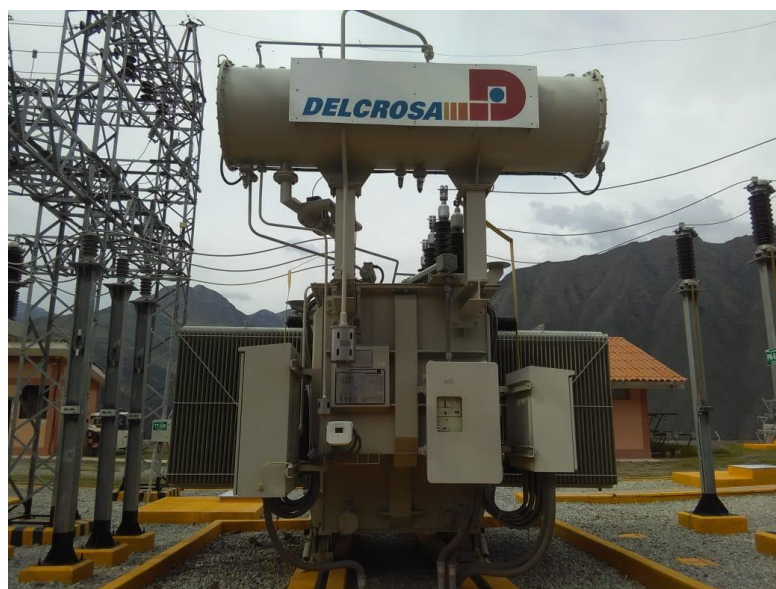
Figura N° 3. 5: S.E. Urubamba. Transformador de potencia tres devanados YN0yn0d5 S.E. Urubamba
