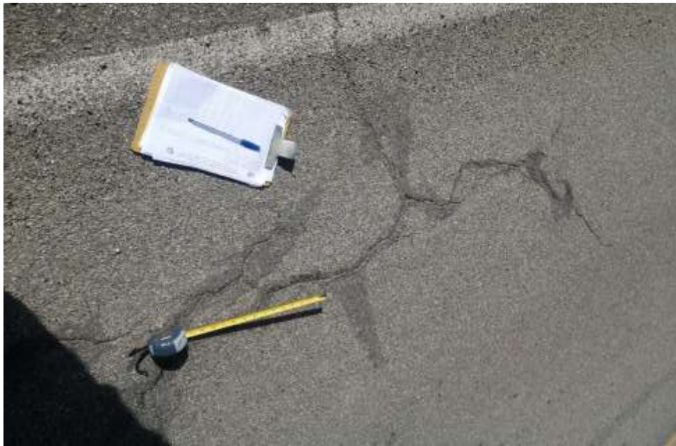
Fotografía 08: Se muestra la presencia de fallas de grietas longitudinales y transversales en nivel de severidad baja, en el tramo II.
