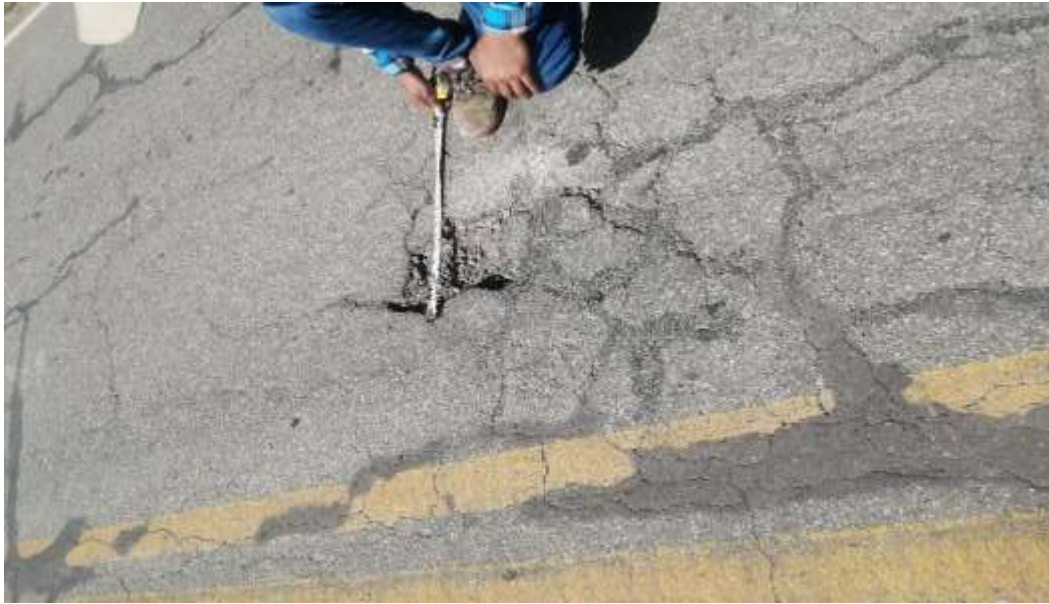
Fotografía 11: Se muestra la presencia de fallas de piel de cocodrilo de severidad alta en el tramo III
