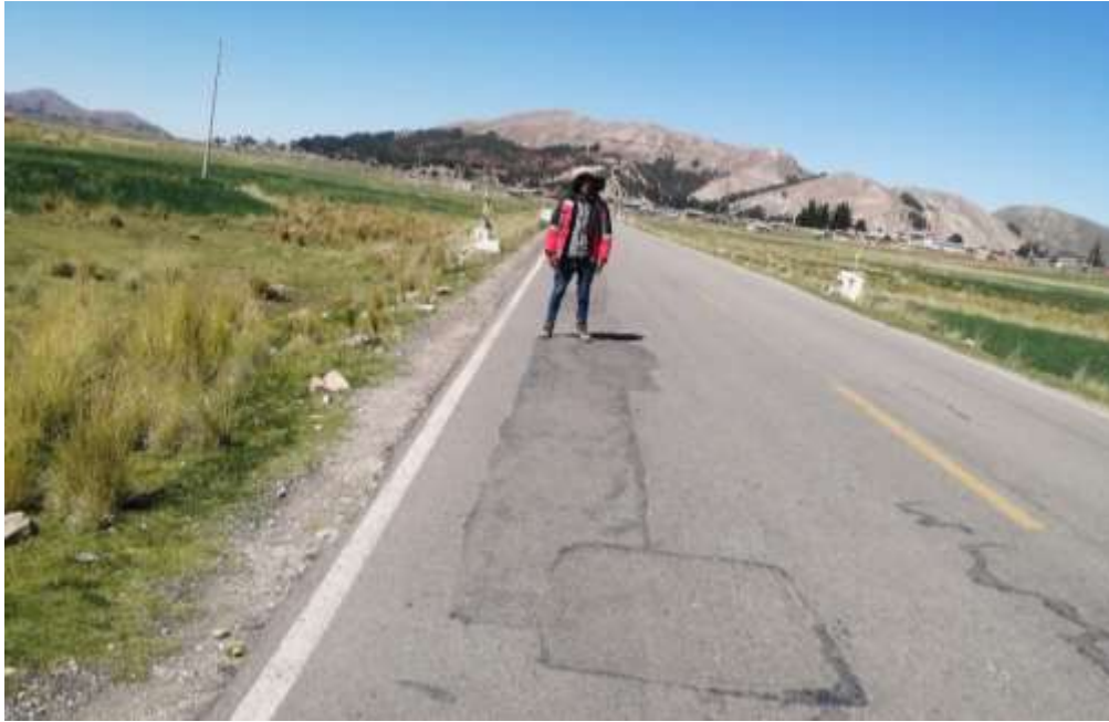
Fotografía 13: En la foto se aprecia fallas de parcheo moderadamente deteriorado nivel de severidad baja, en el tramo III
