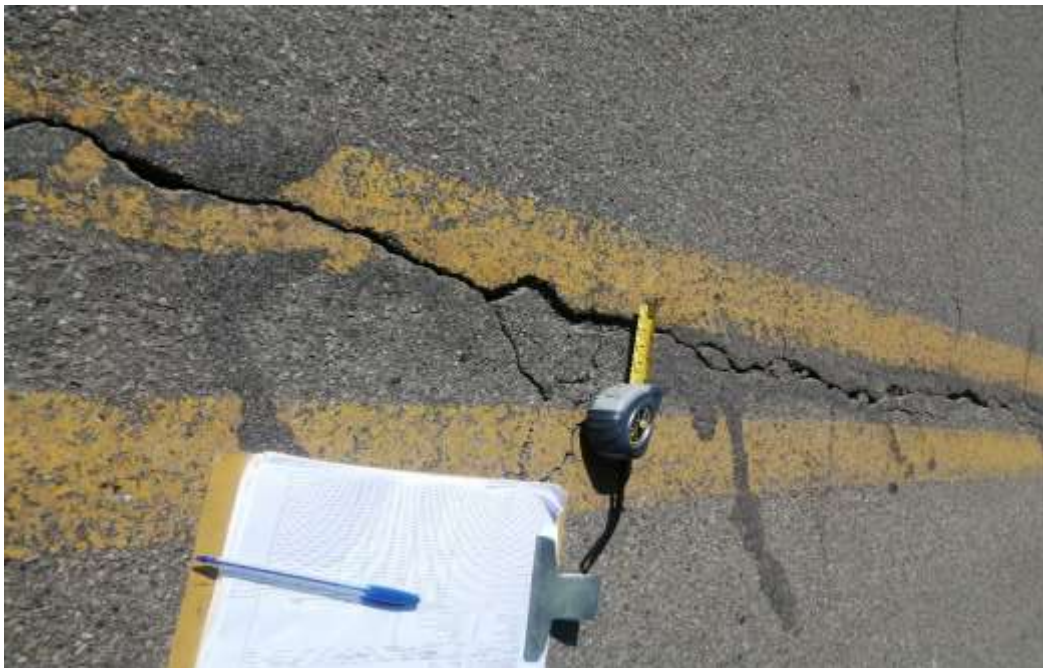
Fotografía 10: Se muestra la presencia de fallas de grietas longitudinales y transversales en nivel de severidad alta, en el tramo II.
