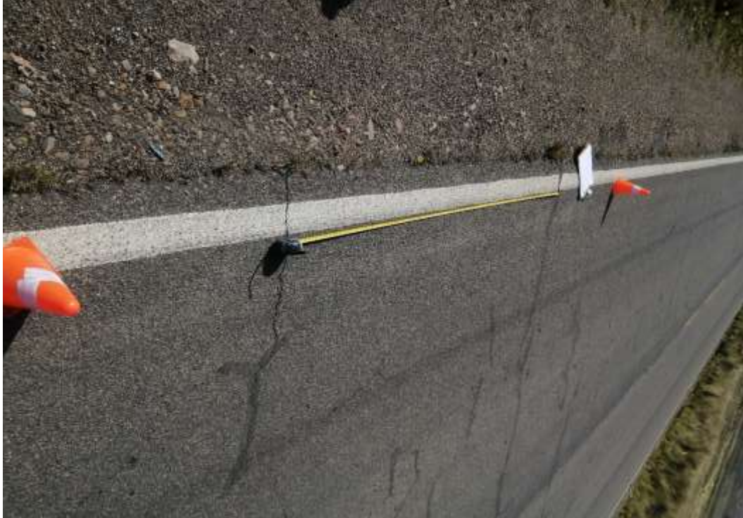
Fotografía 09: Se muestra la presencia de fallas de grietas longitudinales y transversales en nivel de severidad baja, en el tramo II.
