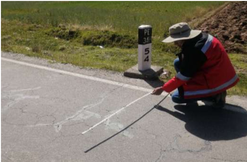
Fotografía 12: Se muestra la presencia de fallas de agrietamiento en bloque nivel de severidad baja, en el tramo III
