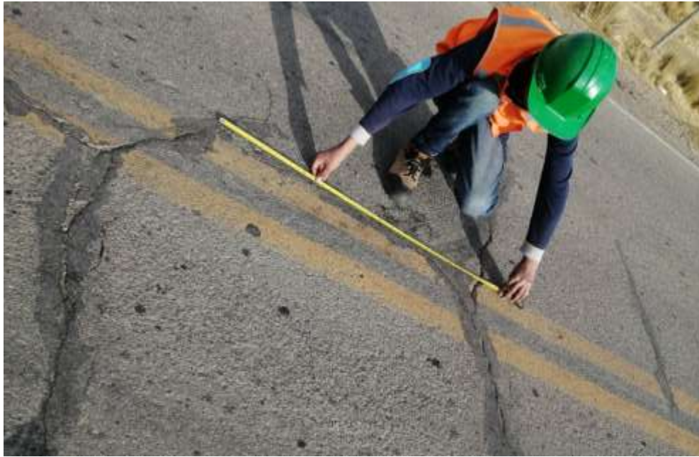
Fotografía 07: Se muestra la presencia de fallas de grietas longitudinales y transversales en nivel de severidad alta, en el tramo I.
