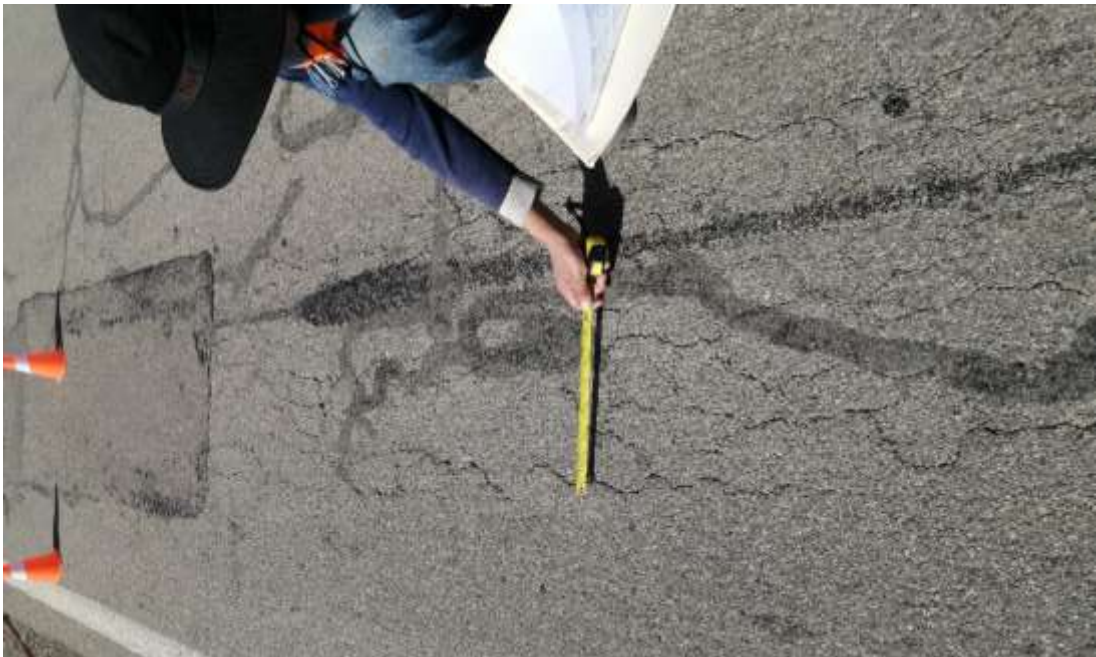
Fotografía 02: Se muestra la presencia de fallas de piel de cocodrilo de severidad baja en el tramo I.
