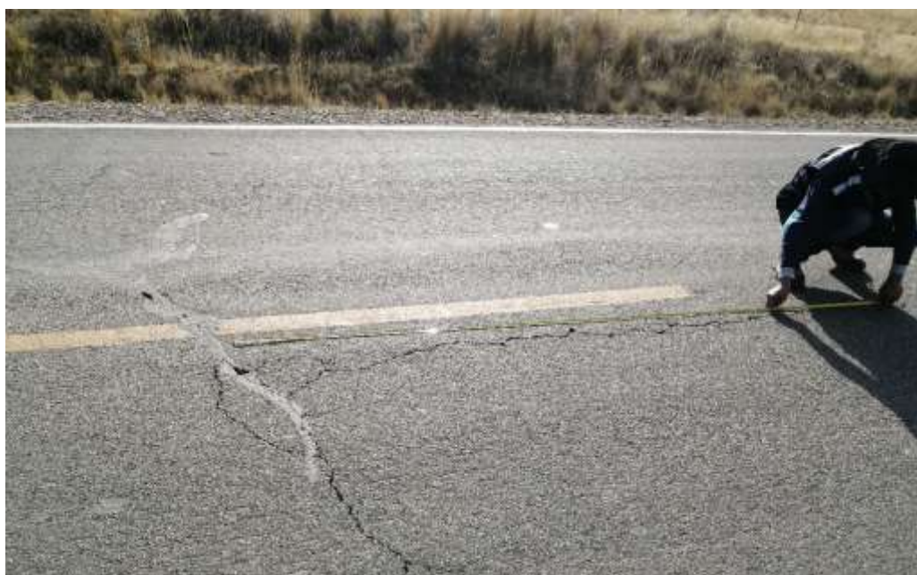
Fotografía 04: Se muestra la presencia de fisuras longitudinales y transversales de severidad media en el tramo 1.
