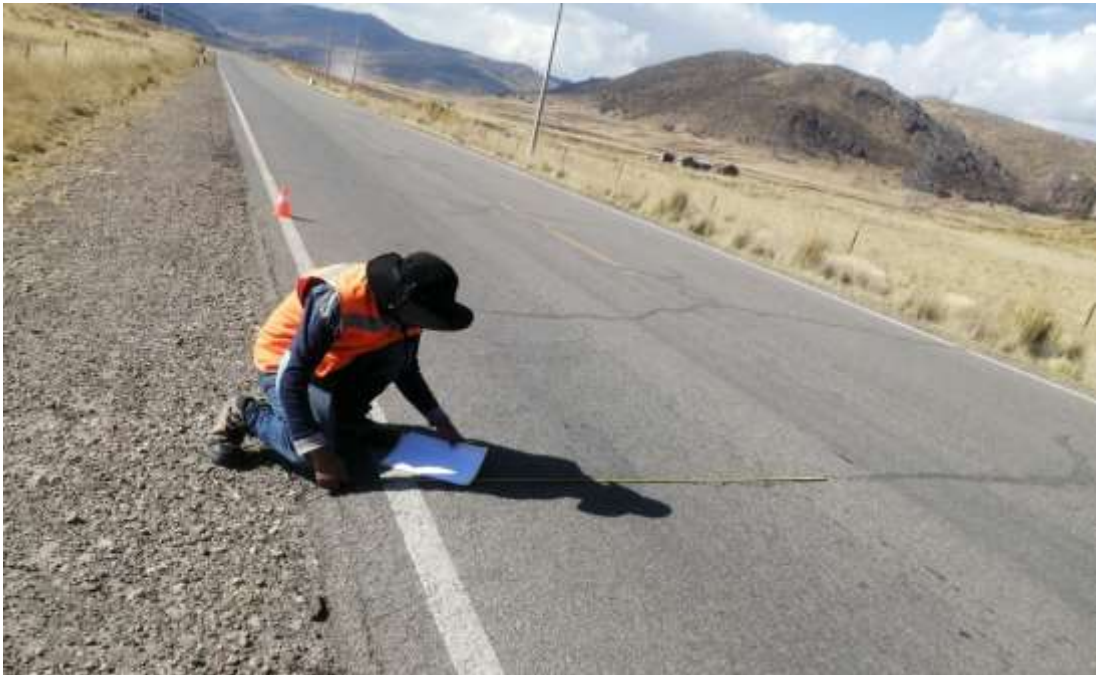
Fotografía 01: Se muestra la presencia de fisuras transversales de severidad baja en el tramo I.
