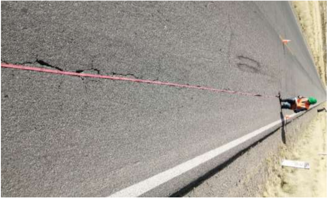
Fotografía 05: Se muestra la presencia de fisuras longitudinales de severidad media en el tramo I.
