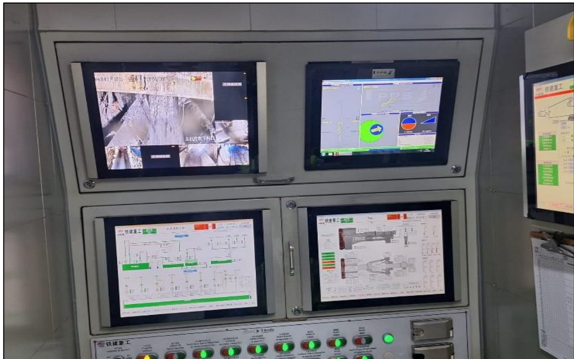
Figura 16. Cabina de control de tuneladora TBM.
