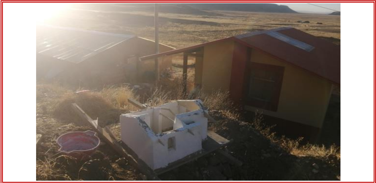
FOTOGRAFIA 29 DESCRIPCIÓN EN LA IMAGEN SE PUEDE OBSERVAR EL REVESTIMIENTO DE YESO DE PROTOTIPO
