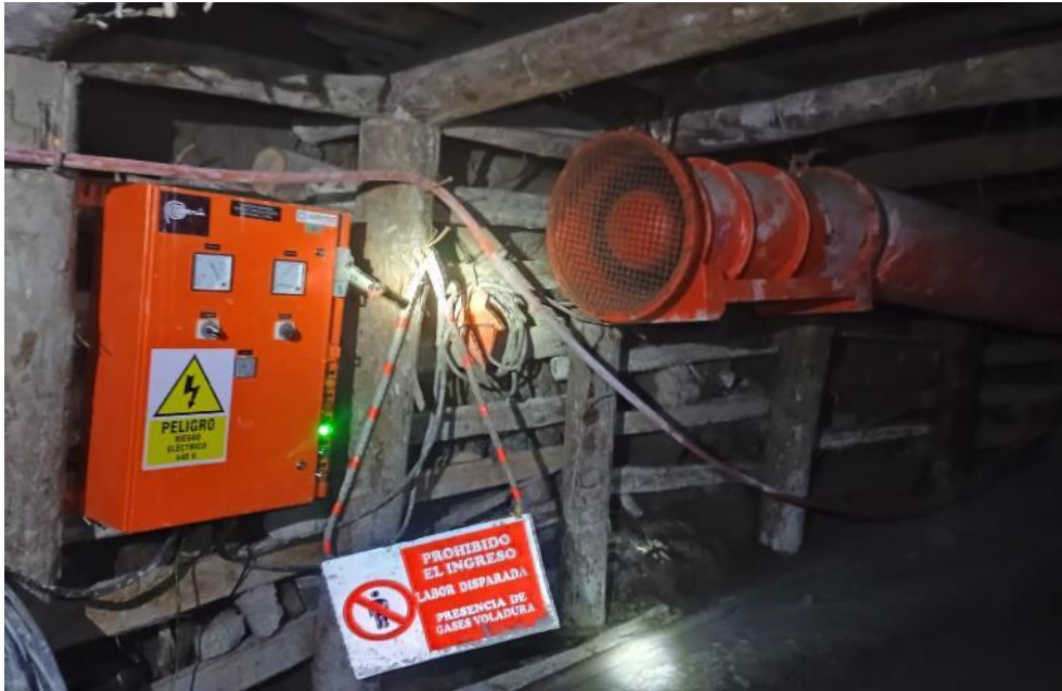
Nota. Ventilador extractor de 5 000 cfm instalado en el crucero 035.
