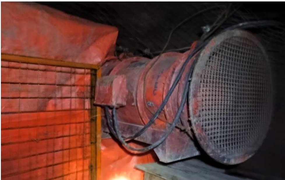
Nota. Ventilador inyector de 10 000 cfm instalado en el tajeo 990.
